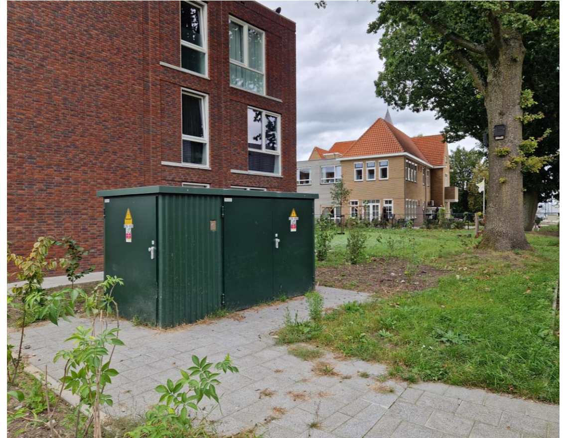
Afbeelding: elektriciteitshuisje PACTO 20
